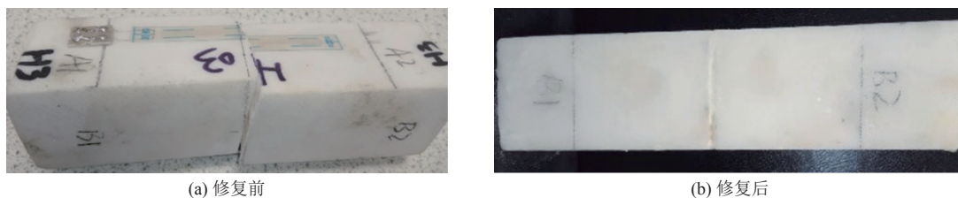
图14 贯通裂缝石梁修复前后的石梁外观对比图 [41]
